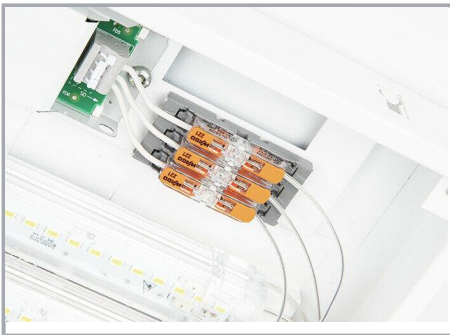
Mehrpolige, lagefixierte Verdrahtung einer Leuchte
